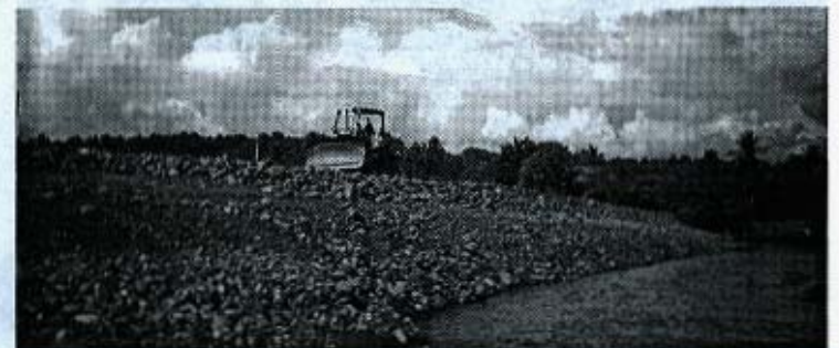
Dique para evitar la inundación en uno de los sectores del Río Parrita, Costa Rica
